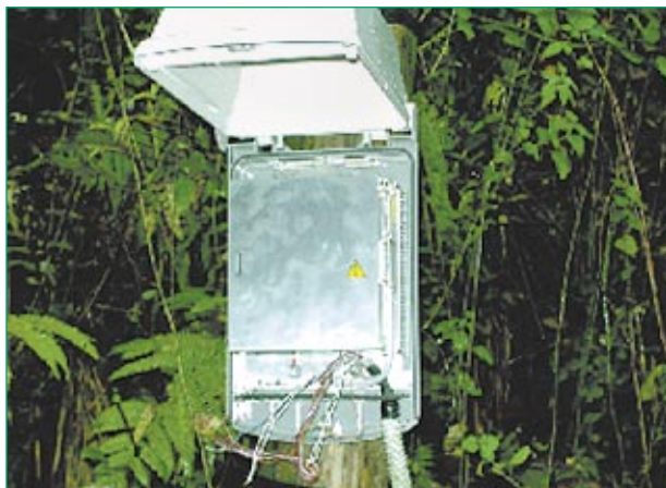
Figura 6 Rigeneratore installato a palo.
