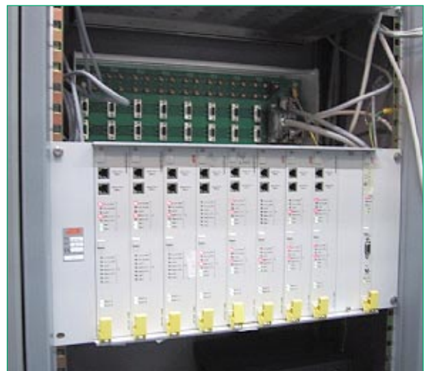
Figura 3 Subtelai completamente equipaggiato. Nella parte superiore l'area per l'attestazione dei cavi.
