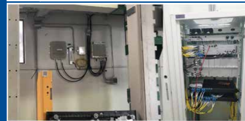
Figura A: Particolari della soluzione di accesso radio 5G installata presso l'Azienda metalmeccanica salentina
