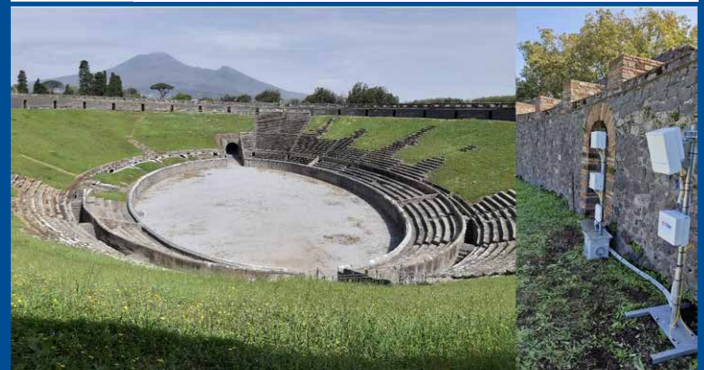
Figura B: Installazione antenne micro per soluzione di accesso radio 5G Millimeter Wave 26 GHz presso l'Anfiteatro Romano di Pompei
